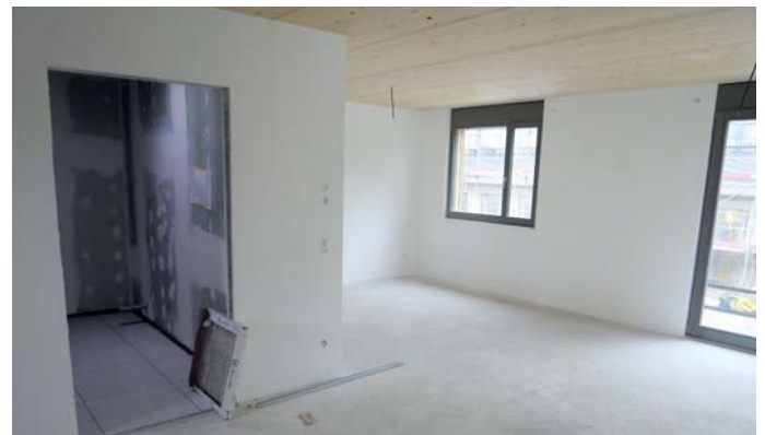
Hell und barrierearm sollen die Wohnungen „An den Höfen“ in Uettingens neuer Ortsmitte sein.
